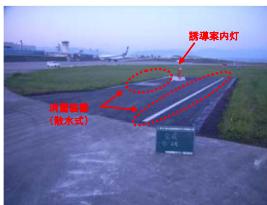
富山空港:散水式消雪設備
